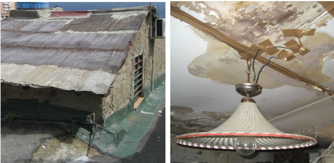
Lo stato delle baracche ad Annunziata foto Cristian Dalmasso
